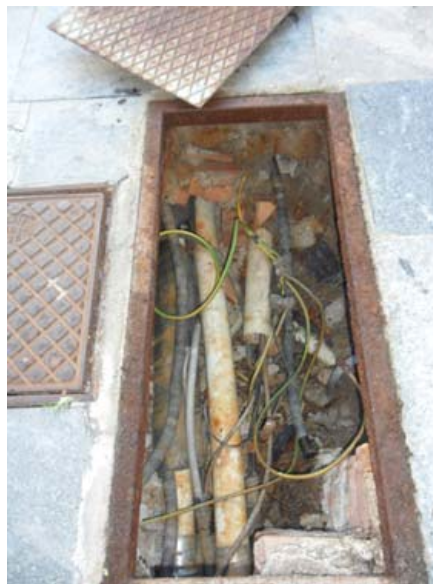
Pozzetto ingresso tubazioni imp. riscaldamento da Centrale Termica, presso lato sud vetrata ingresso Municipio
