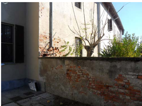
Muro confinante e pozzetti interrati, presso punto d'innesto fra i due corpi di fabbrica (lato ovest)
