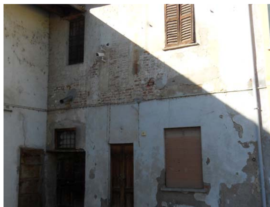
Prospetto verso cortile sud – vedi cavi in facciata
