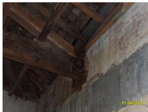
Vista innesto capriata ammalorata - locale 4
