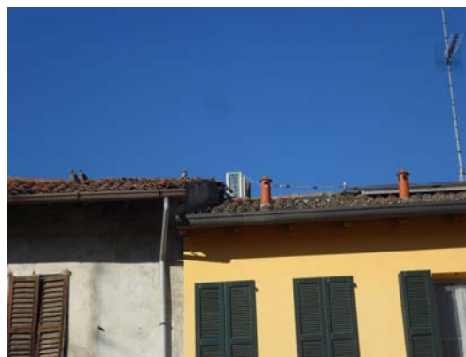
Impianti tecnologici su copertura proprietà confinante.
